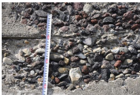
写真-6 下流側面の骨材露出
