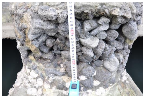
写真-5 堰柱水切りの骨材露出
