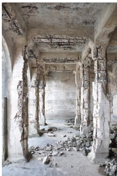
写真-4 柱梁の劣化状況
