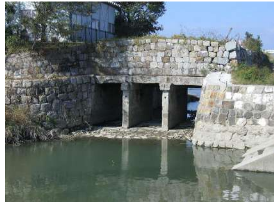
写真-4 江中樋(大鞘樋門群のひとつ)
